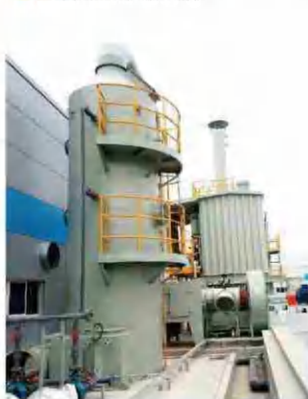
■ 上海韩智实业RTO系统
