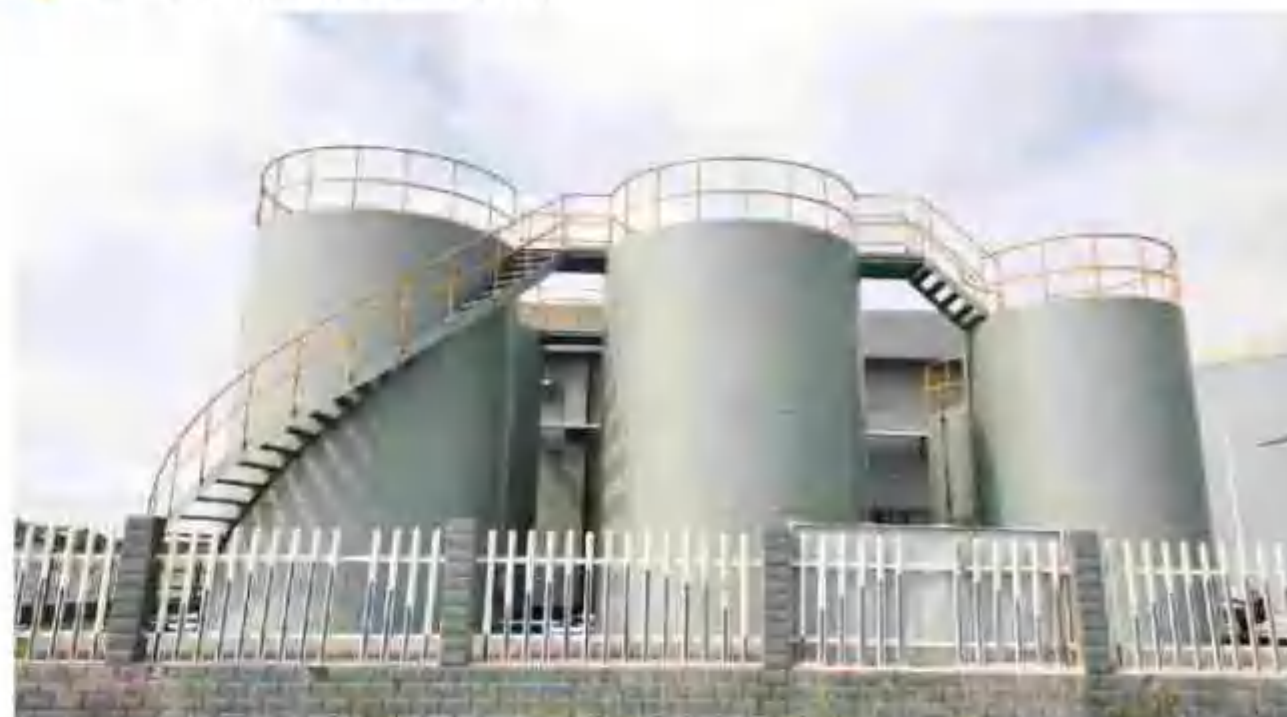
■ 光大滨海垃圾焚烧发电厂项目设备
