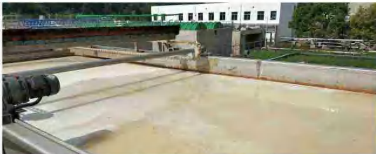
■ 湖南元和生物气浮项目
