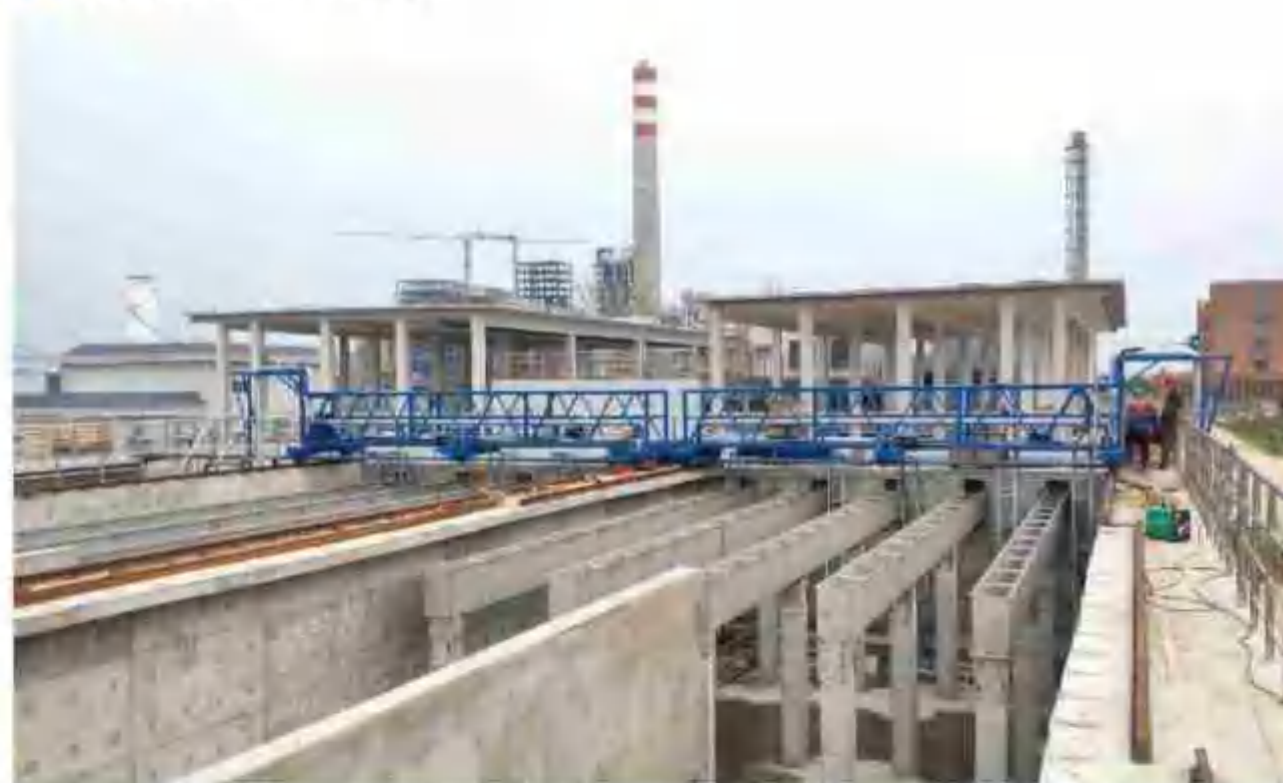
■ 安徽昊源化工自备自来水厂
